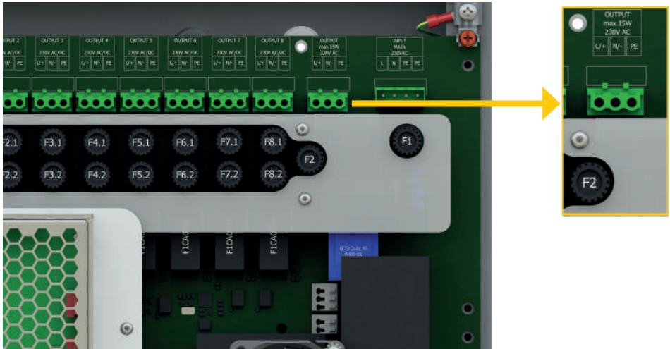
Abb. 20: Anschluss externe AC-Verbraucher
