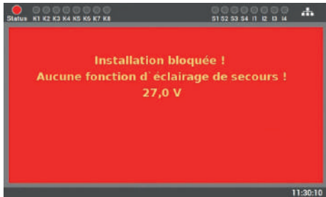
Fig. 26: Écran blocage de l'éclairage de secours
