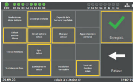
Fig. 114: Défauts tableau de signalisation
